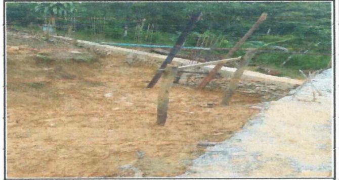
Foto 2: Finalización de la activación de muro perimetral, teniendo una altura de 7 metros la parte frontal derecha y un largo de 60 metros. La parte trasera tiene una altura 6 metros y de largo 15 metros.
